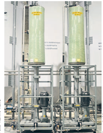
Die schlammverträglichen Umkehrosmosemodule stehen auf Vibrationskörpern.
