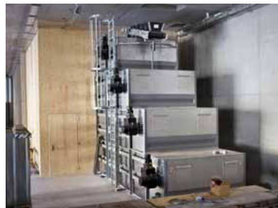
Der größte Teil des Bandrockners ist in einer Holzverschalung eingekapselt.
